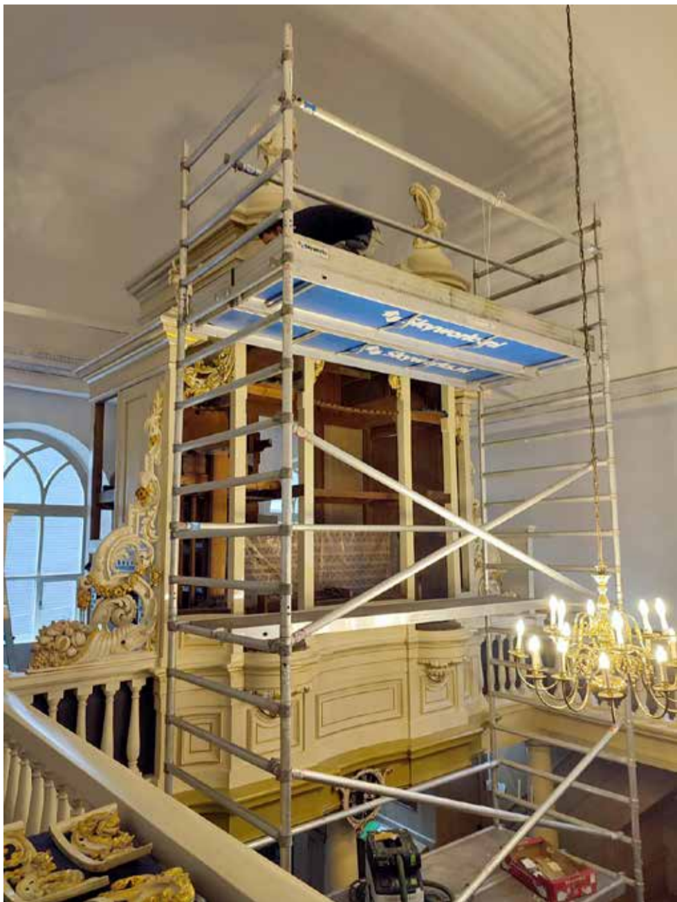
Het Van Dam-orgel in de Lutherse Kerk te Leeuwarden tijdens de restauratie. De kas wordt opnieuw geschilderd door vader Jilt en zoon Hedser Heidstra. Het fraaie instrument heeft nog altijd de originele kleur uit 1869. (Foto: Ad Fahner)
